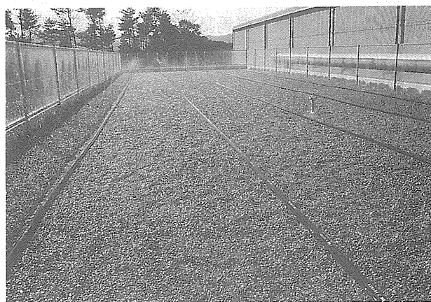
微生物脱臭槽
